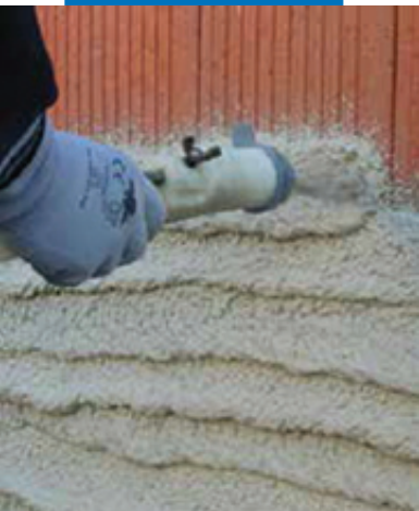
Нанесение MapeWall Intonaco Base штукатурной станцией поверх новой стены из перфорированного кирпича
